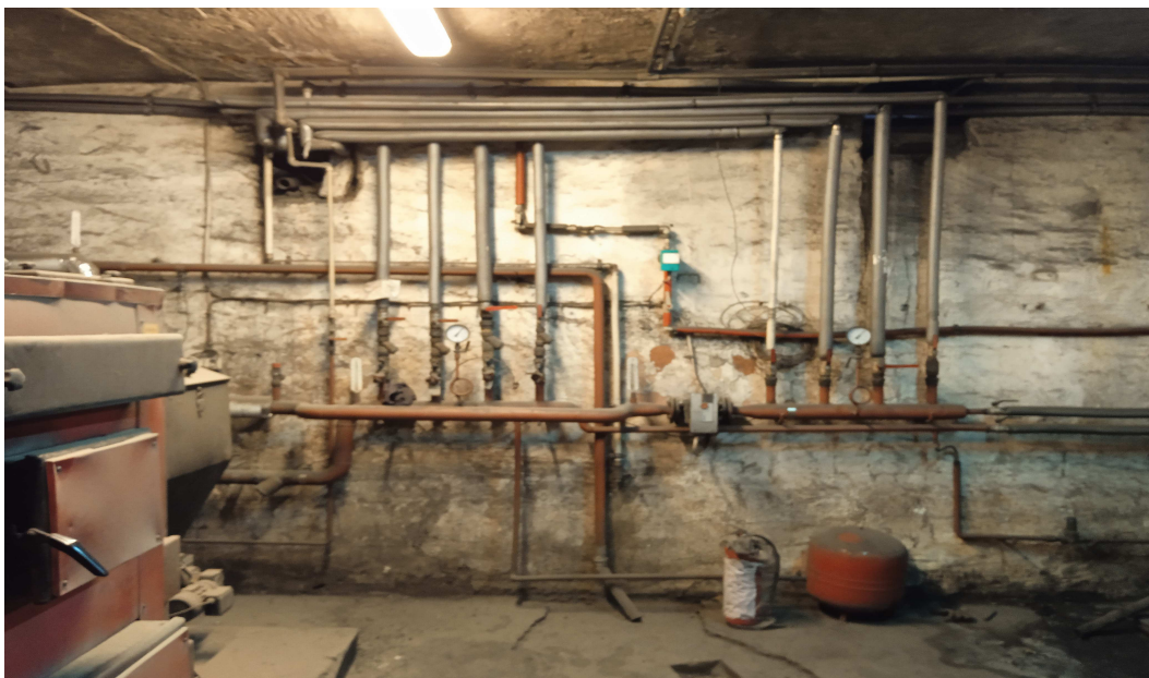
Zdj. 3 Istniejący układ rozdzielaczy c.o. i c.w.u. w kotłowni
