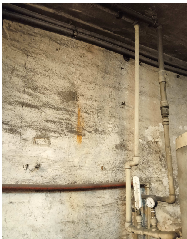
Zdj. 4 Miejsce podłączenia do istniejącej instalacji c.w.u. i cyrkulacji
