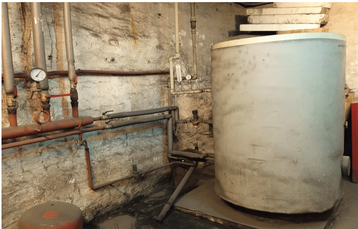
Zdj. 2 Istniejący zasobnik c.w.u. z węzownicą przeznaczony do demontażu.
