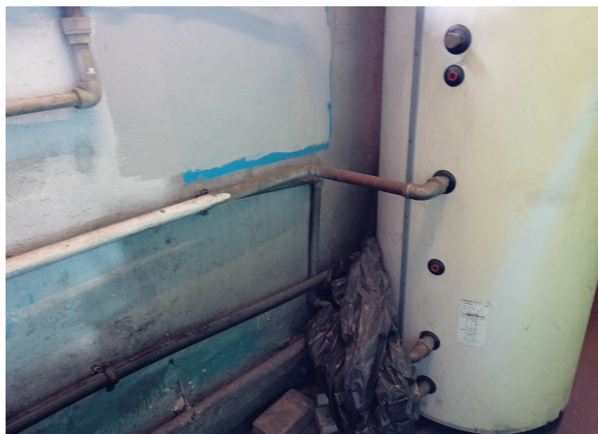
Zdj. 2 Istniejący zasobnik c.w.u. z węzownicą przeznaczony do demontażu.
